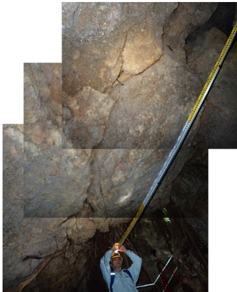
図-5 エリア 7 出口付近の地下空洞の天端状況。遊離岩塊が天端を構成している。
