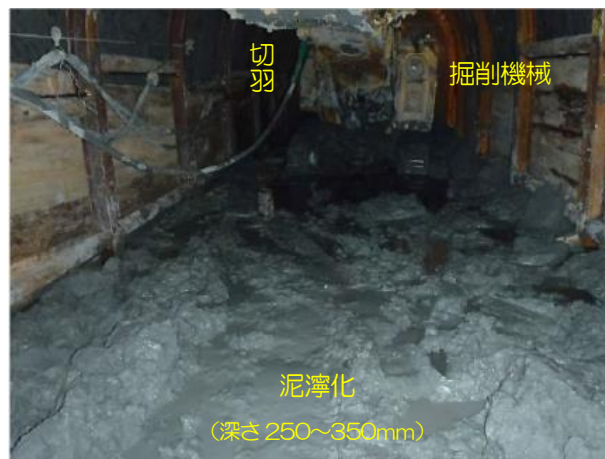
写真-1 切羽部のトンネル基盤 泥濘化状況
