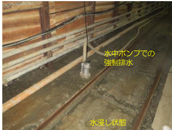
写真-2 掘削後のトンネル基盤の湧水状況
