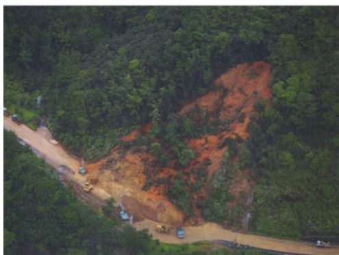
写真-3 屋入地すべりの全景
