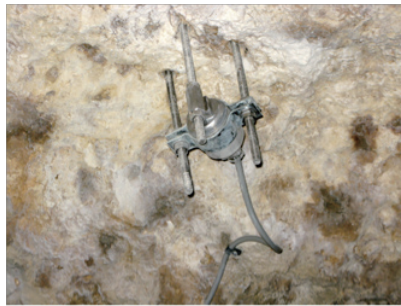
図-18 B 空洞天端に設置した AE 測定装置
