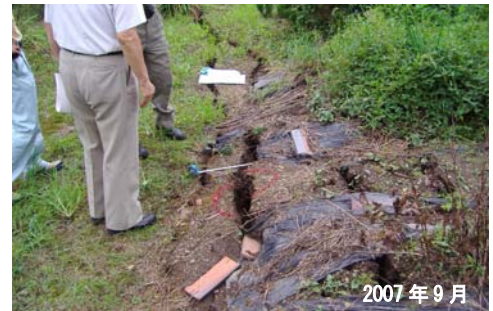
写真-2 亜炭廃坑による陥没と地表面の亀裂（岐阜県御嵩町）
